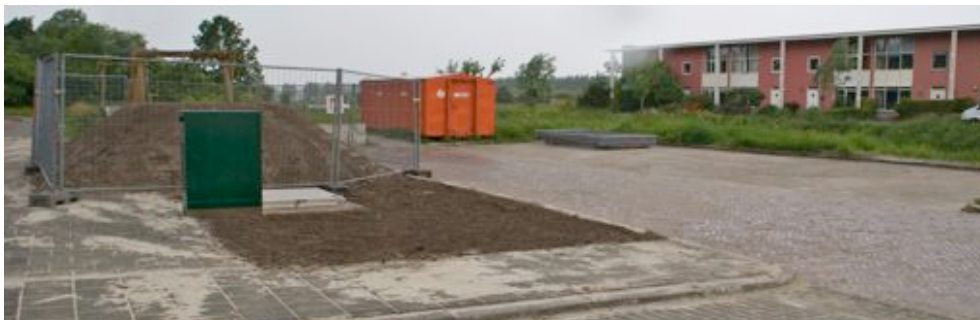
Septic tank, net aangelegd
