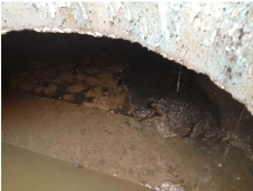
Fig. 9 Sliblaag in midden-compartiment van de septic tank, gezien vanaf het influentcompartiment (foto: 16 september 2014). Bij toevoer van influent stroomt het water over de sliblaag naar het effluentcompartiment.
