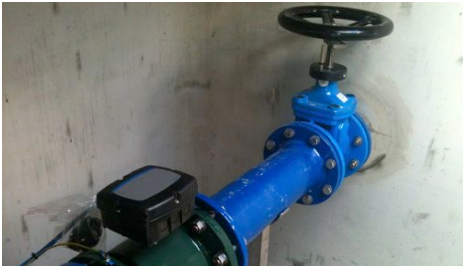
Doseerkraan en debietmeter zwartwater (foto Jan van Dijk)
