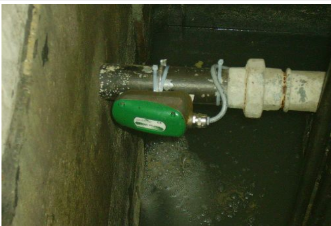
Debietmeter op de persleiding richting VHF
